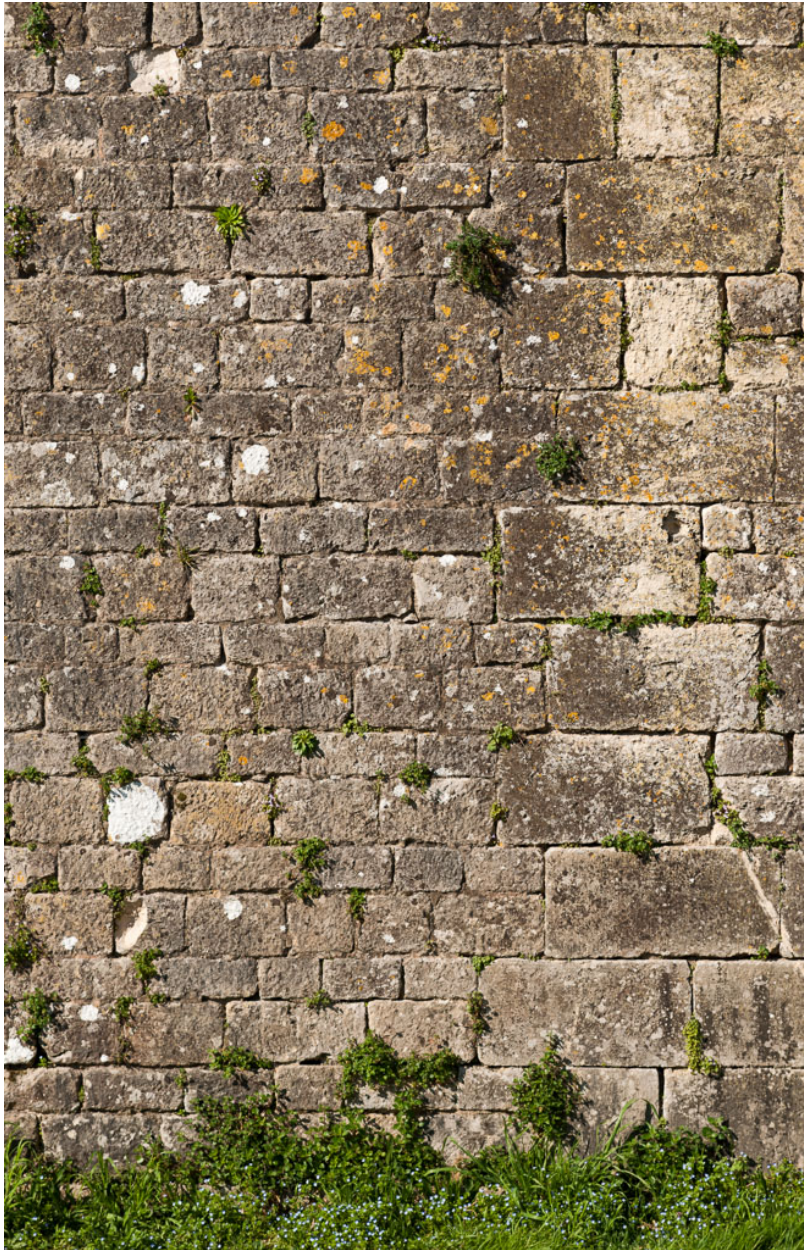
Bastion du château : détail d'une reprise de maçonnerie sur le côté gauche du saillant.
