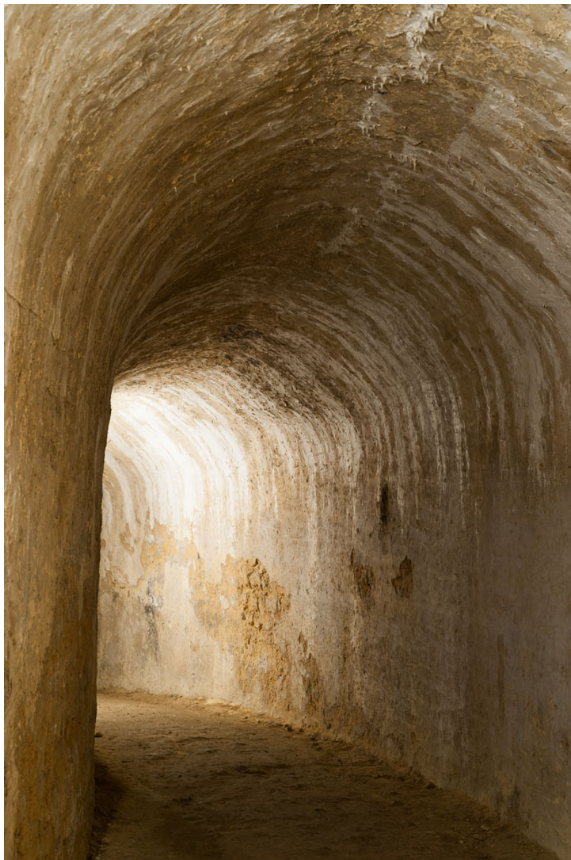
Couloir souterrain de liaison entre la poterne du bastion du château et la fausse-braie du côté du front du Cône au nord : détail.
