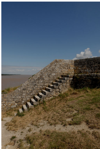
Escalier du chemin de ronde près de la tour de l'Eguillette. Phot. Michel Dubau IVR72_20093300170NUC2A
