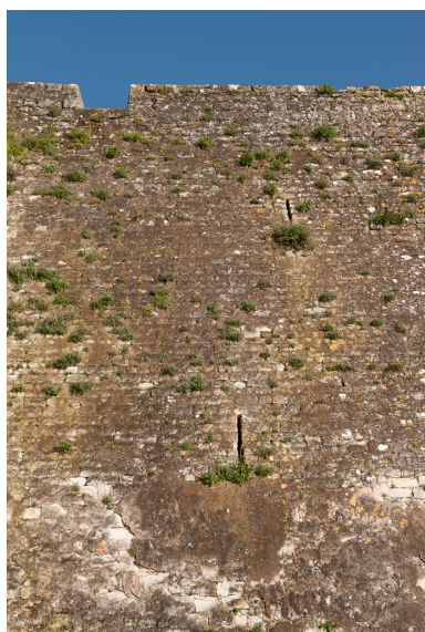
Front de la courtine face à l'estuaire, secteur sud-ouest : détail. Phot. Adrienne Barroche IVR72_20113310801NUC4A
