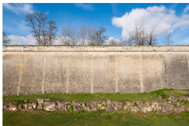
Courtine entre la porte dauphine et le bastion du port. Phot. Adrienne Barroche IVR72_20113310667NUC4A
