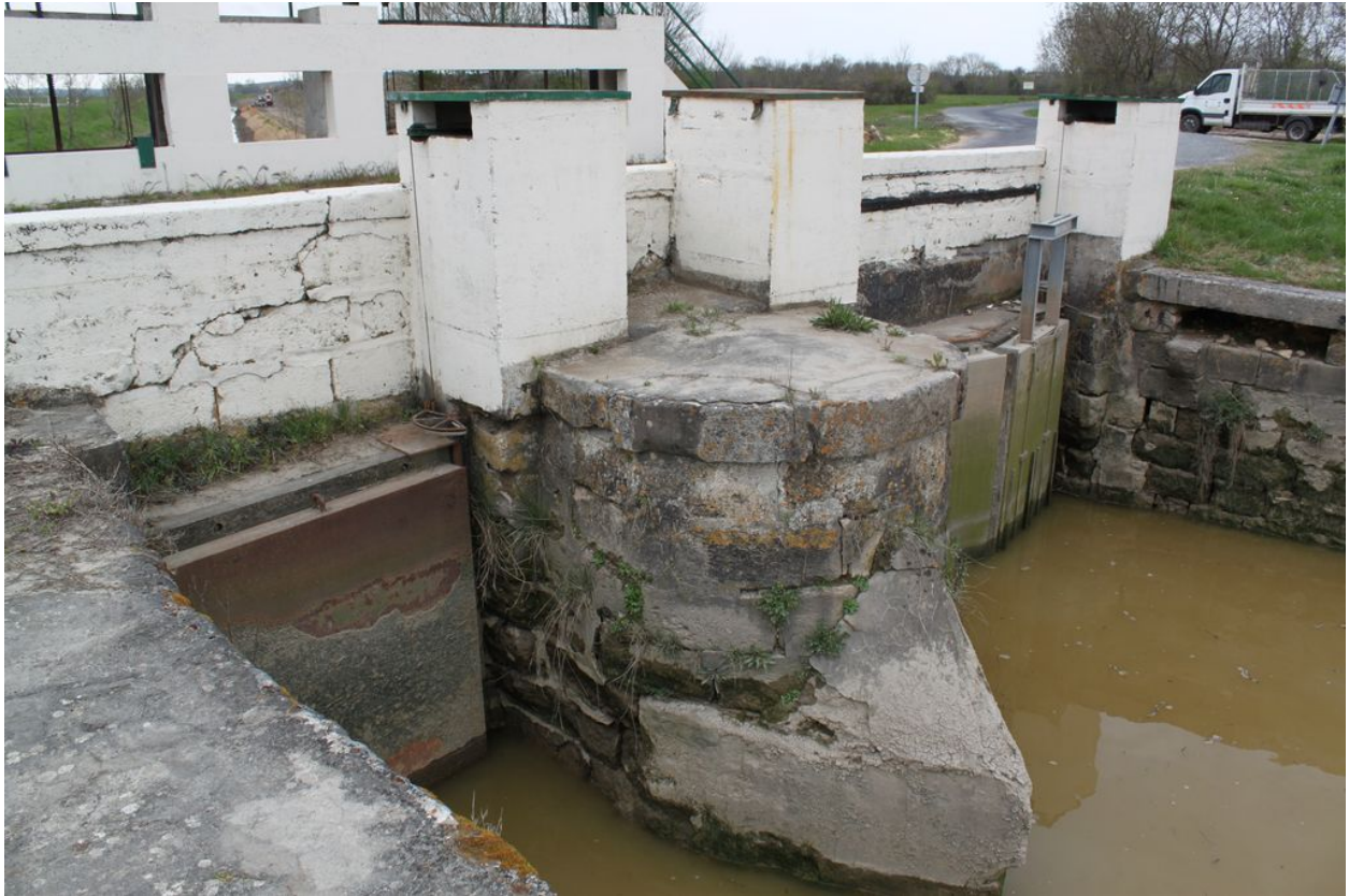
Pont de l'estey : détail du bec entre les deux portes à flots.
