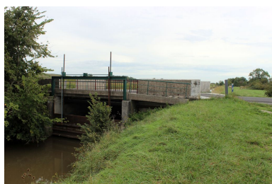
Pont de la Calupeyre et pelle à crémaillère. Phot. Claire Steimer IVR72_20163301954NUC2A
